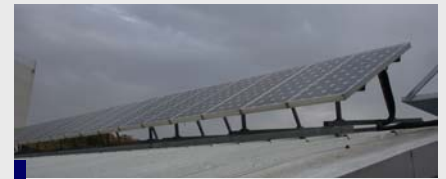
Campo solar en cubierta
