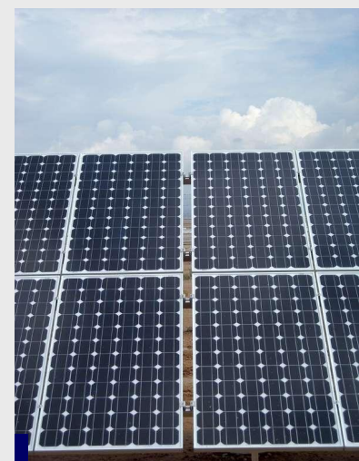
Módulo solar y estructura
